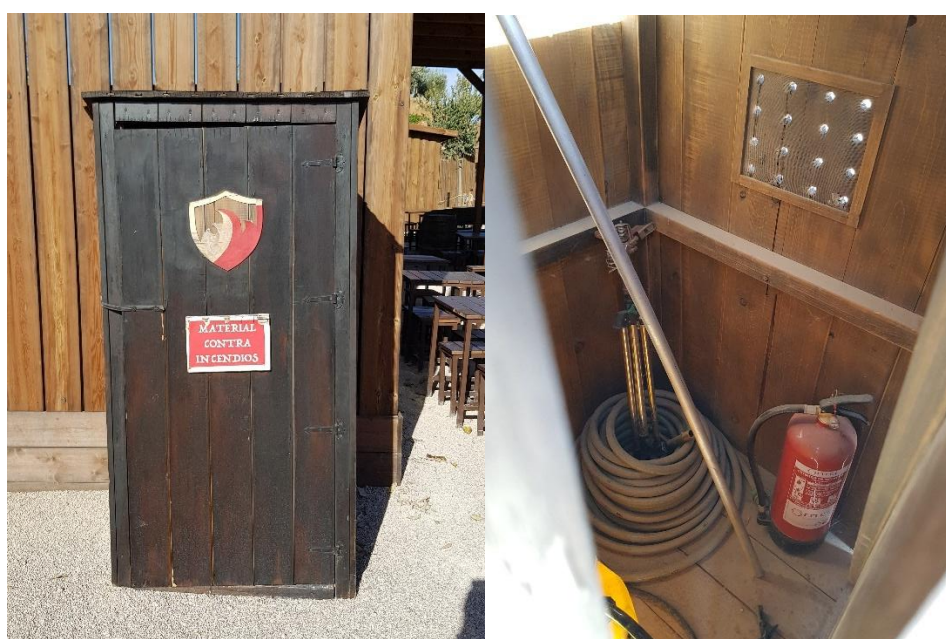
Foto 3-25. Material contra incendios presente en las zonas del parque abiertas al público.
