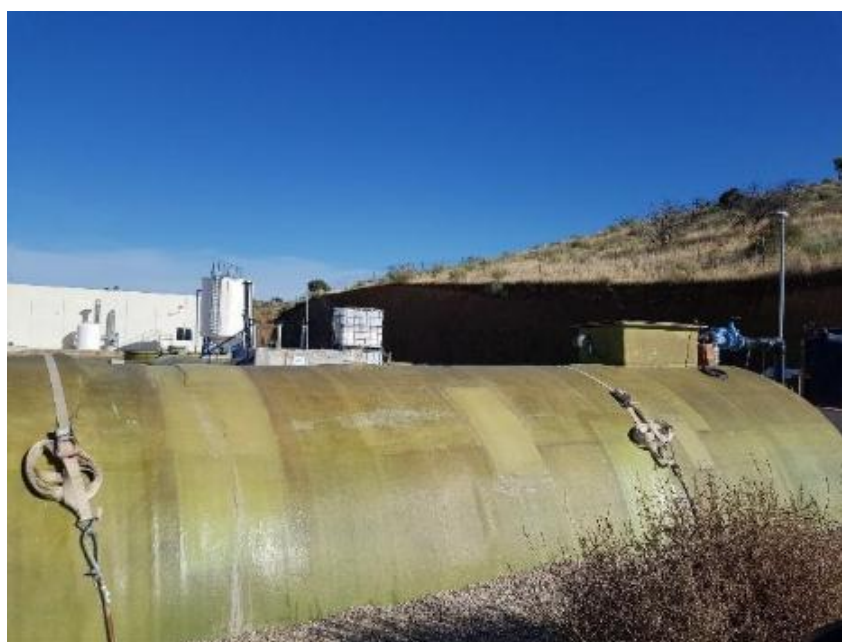
Foto 3-3. Fisuras reparadas en el tanque de homogeneización de la EDAR.
