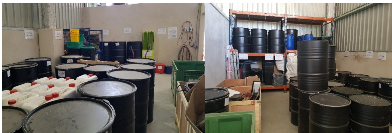
Foto 3-31. Izquierda: reorganización de los contenedores de residuos peligrosos realizada en enero para facilitar el paso y las maniobras. Derecha: instalación de estanterías en el recinto de almacenamiento.
