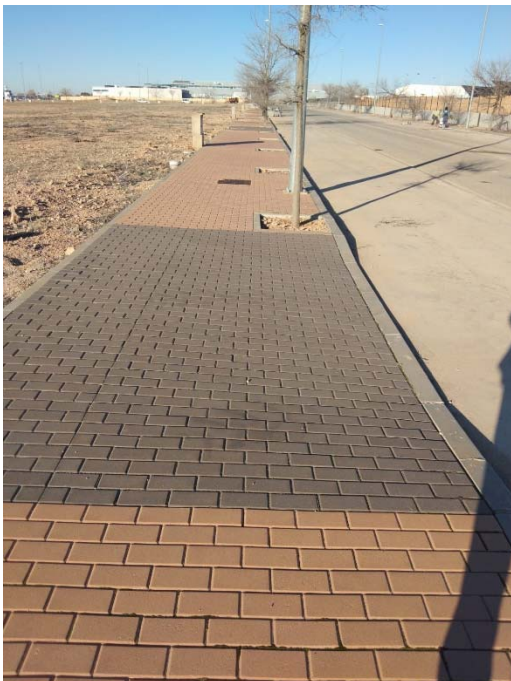
18. Acerado vial D. Casi todos los alcorques sin árbol y donde hay seco...
