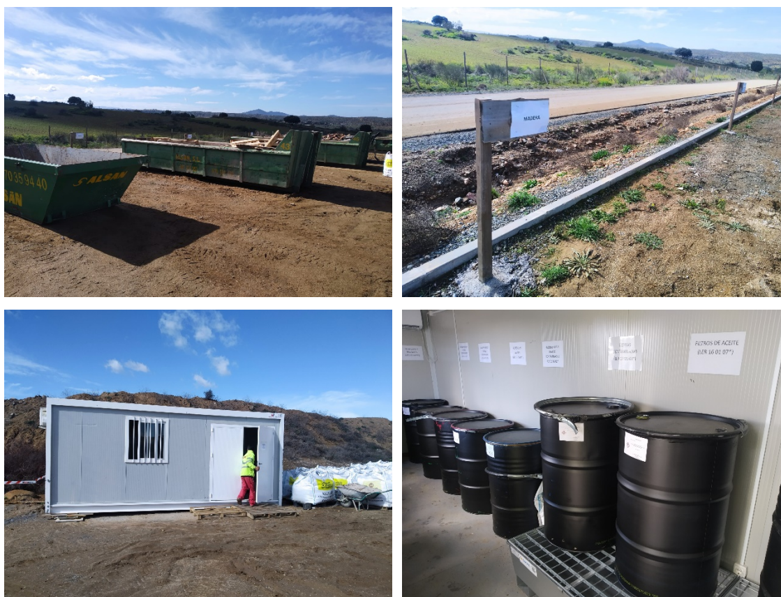
Figura 4.2. Imágenes de los contenedores de inertes y la cartelería indicativa de la tipología de residuos que contienen. Y vista exterior de la caseta de residuos peligrosos y de los contenedores de almacenaje de su interior.
